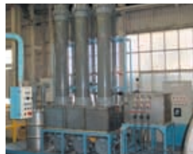
揚水ばっき装置
