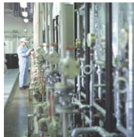
ユーティリティ設備の配管の流量測定による運転台数の適正化
