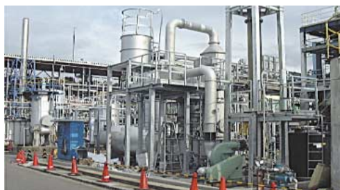
VOC排ガス燃焼装置
